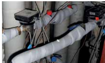
Балансировочные клапаны Danfoss ASV и теплосчетчики установлены в каждом техническом помещении для каждой группы из четырех квартир.
